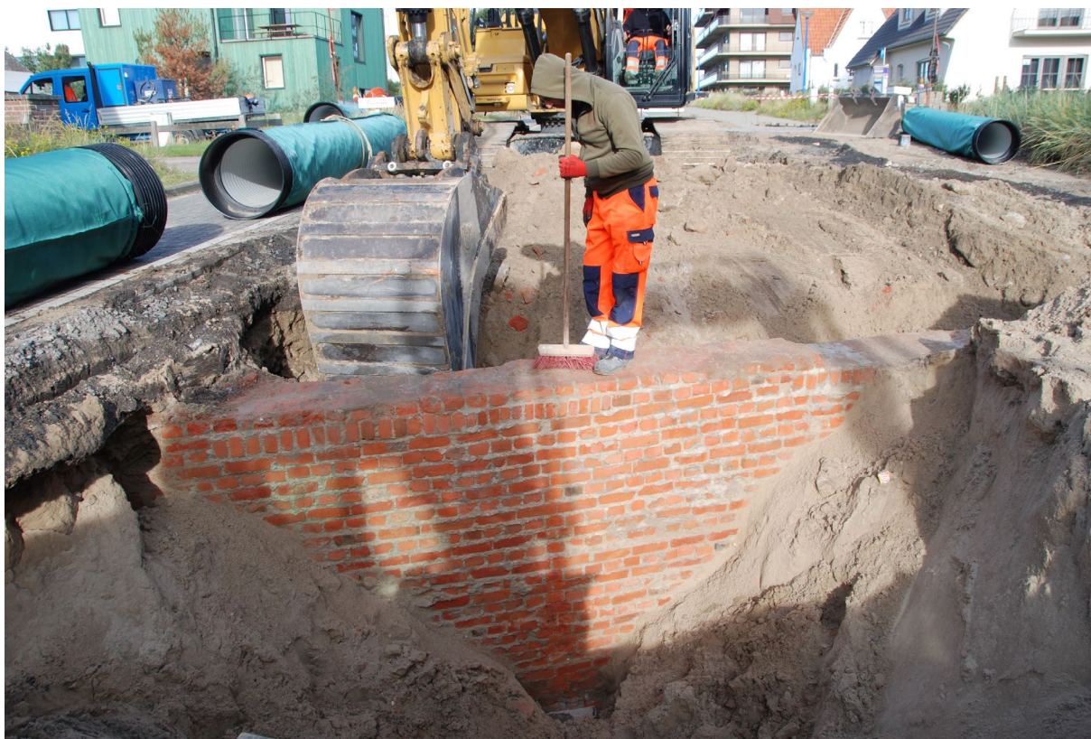
Figuur 1: Toevalsvondst TV ID 355, 12 oktober 2018. Tijdens wegeniswerken kwam een gemetste muur uit de Tweede Wereldoorlog aan het licht die tot net onder het asfalt reikte en het wegtracé dwarsste. Foto naar het noorden, op de dag van de ontdekking, bij de graafwerken door de aannemer.
