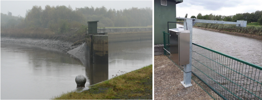
Figuur 49: Tijmetingen te Duffel Sluis (Nete) met rechts zicht op de vrijstaande OTT radar
