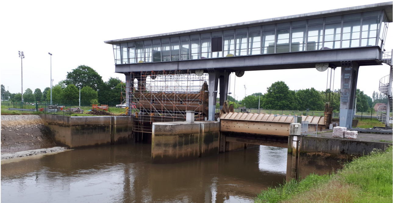
Figuur 60: Tijmeetlocatie te Mechelen Stuw afwaarts
