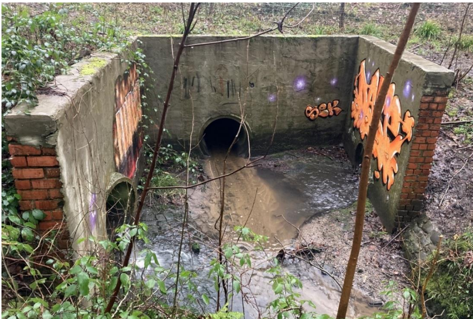
Figuur 95 Inspoeling van vervuild water. Zoniënwoud, Vlaams-Brabant.
