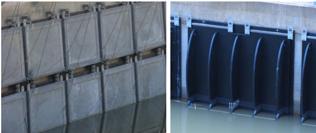
Figuur 1 – Voorbeeld kleppen uit houten kader met staal bekleed (Kruibeke, links) en HDPE kleppen (Bergenmeersen, rechts)
