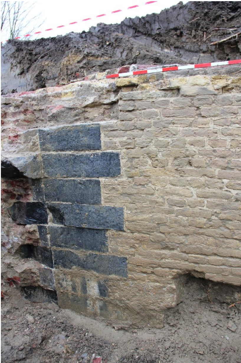
Figuur 20: De deels vernielde zuidoostelijke binnenhoek van de westelijke kazemat (© Onroerend Erfgoed).
