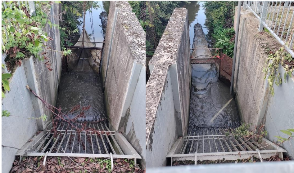
Foto 4: De fuiken constructie stroomopwaarts van de Driesesloot. Onderaan zijn de krooshekken te zien. Links glasaalfuik, rechts normale fuik.
