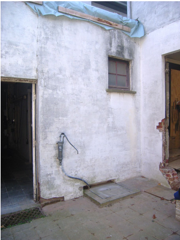
Figuur 5: De achtergevel van het bijgebouw, met pomp en putdeksel van de waterput. © Agentschap Onroerend Erfgoed.
