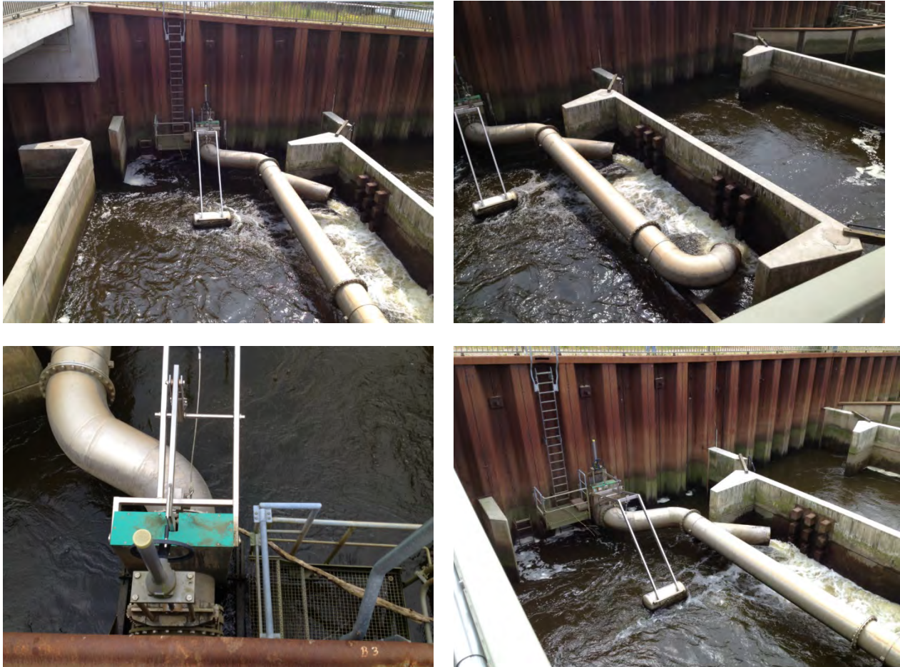
Figuur 58 – Foto's buizen toegevoegd debiet in de bekken van de dubbelslot-vispassage te Geesthacht
