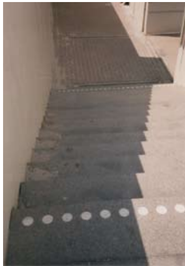
Fig. 2.1.4w De eerste en de laatste trede van deze trap zijn gemarkeerd. De markering is niet ononderbroken en wordt daardoor als minder duidelijk ervaren door slechtzienden.
