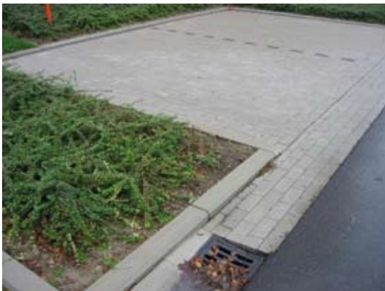
Fig. 2.1.4i Achter parkeerplaatsen (zeker achter aangepaste parkeerplaatsen) mogen geen diepe en/of komvormige goten voorkomen. Een platte goot zoals hier afgebeeld is wel toegelaten.
