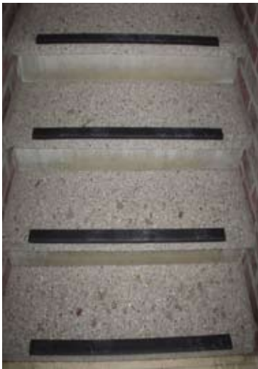
Fig. 2.1.4v Een trap met contrasterende strips boven op iedere trede. Een dergelijke markering wordt door slechtzienden als verwarrend beschouwd.
