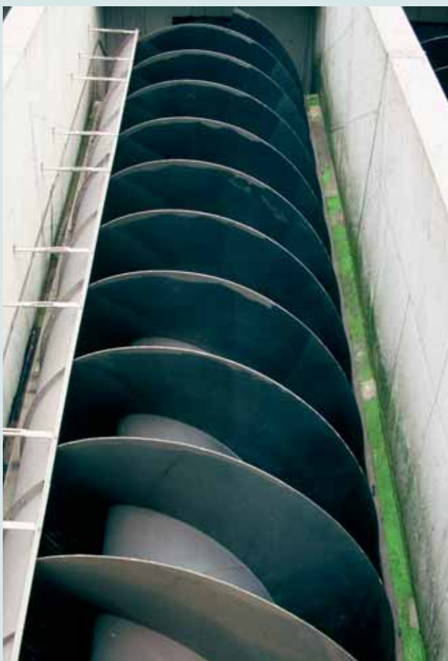
Close-up van een vijzel van het nieuwe pompstation op de Ledebeek te Lokeren.
