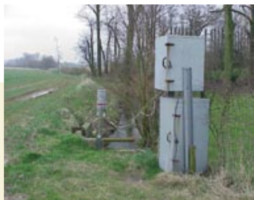
Experimenteel meetstation van de afdeling Water ter hoogte van het wachtbekken op de Plankbeek, kaderend in het onderzoek van erosie en sedimentatie van afspoelende grondeeltjes bij hoge regenval (het wachtbekken werkt sterk als een zandvang).
