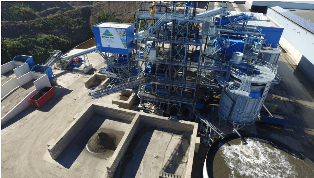
Figuur 12. Natte scheidingsinstallatie, geïnstalleerd bij Bioterra NV te Genk “From Waste to New Resources”
