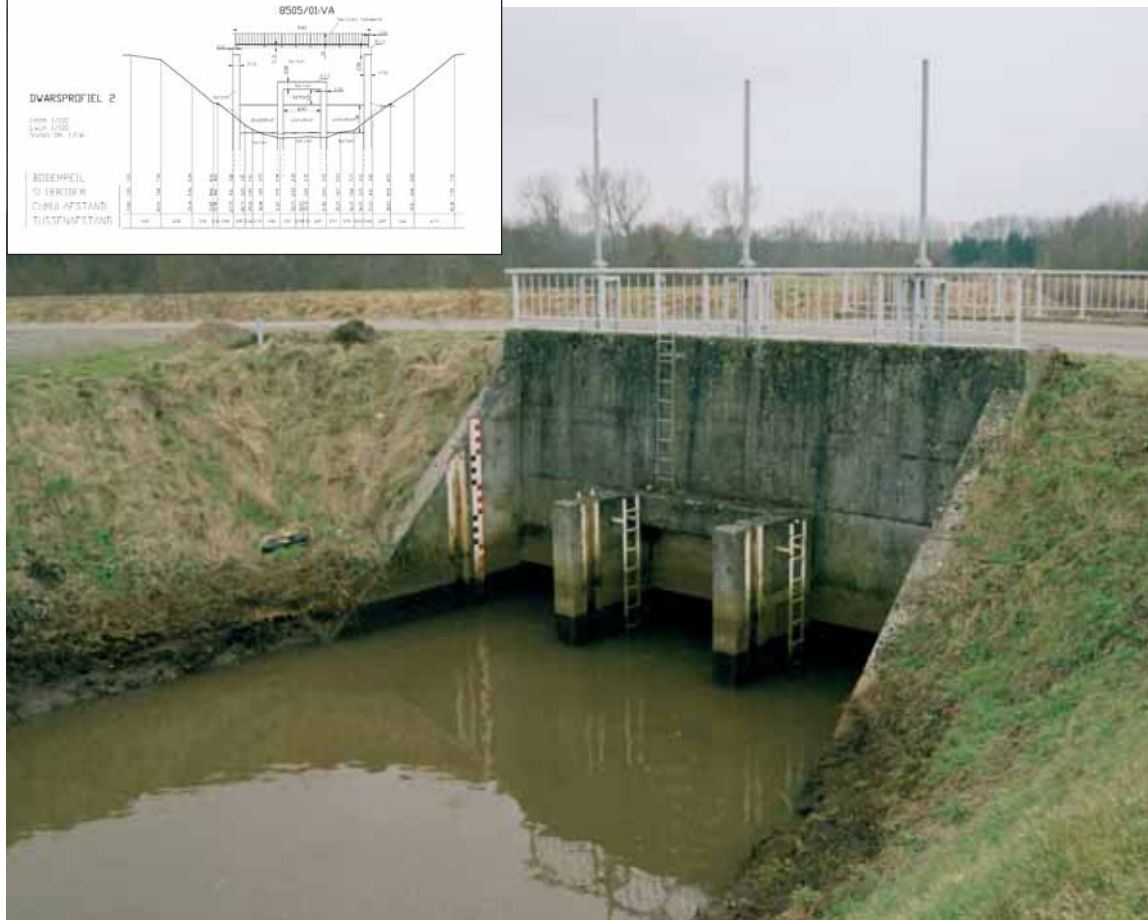
Figuur van het kleppencomplex: Aan de monding van de Bollaak in de Kleine Nete bevindt zich een kunstwerk met 6 terugslagkleppen. Bij laagtij in de Kleine Nete worden deze kleppen door het water van de Bollaak open gedruwd en is afvoer mogelijk. Bij hoogtij worden de kleppen dicht gedrukt door de Nete en is er geen afvoer van de Bollaak in de Kleine Nete meer mogelijk.
