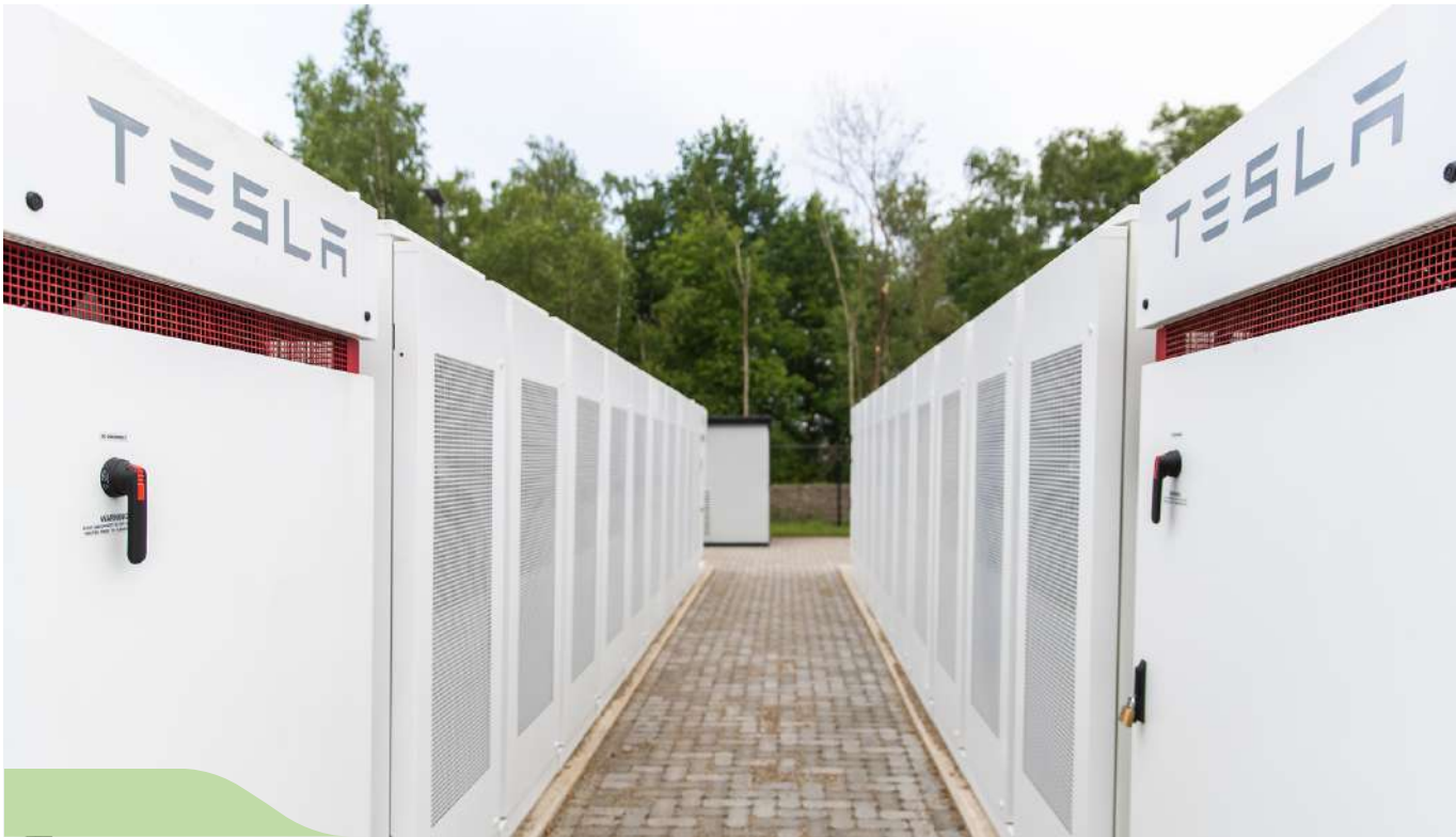
↑ Tesla-batterijproject op de kmo-zone van Terhills.
