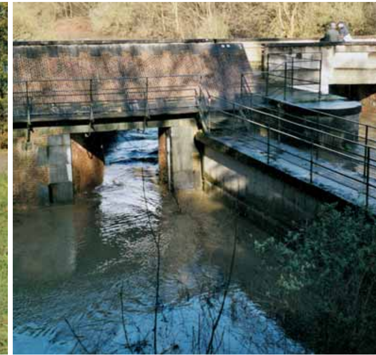
Monding van de Begijnebeek in de Demer ter hoogte van de Grote Steunbeer (februari 2002).
