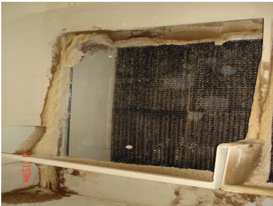
Figuur 13: Zoutvorming in een chemische luchtwasser.
