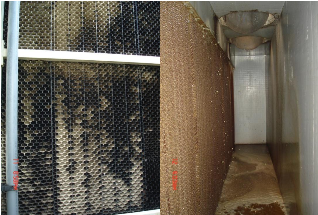
Figuur 10: Droge plekken op het waspakket van de luchtwasser.
