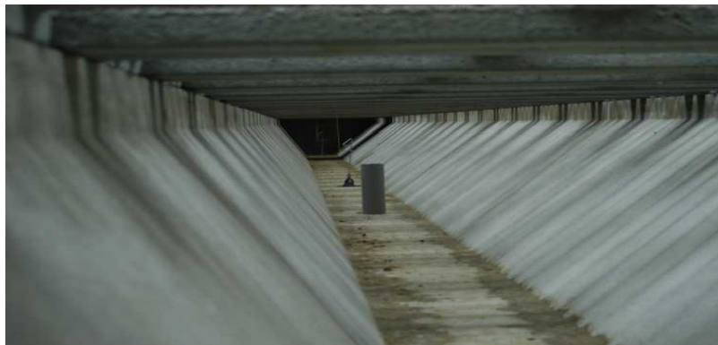
Figuur 51: Overloop in een mestkanaal.
