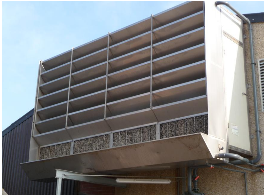
Figuur 14: Buitenconstructie van een luchtwasser.
