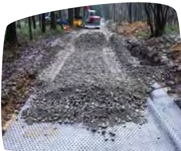
Gebruik van een geogrid om de dikte van de funderingslaag te beperken zonder verlies aan stabiliteit
