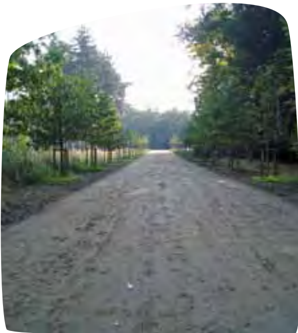
Beeld vlak na beëindiging van de aanlegwerken De vegetatie moet zich nog spontaan ontwikkelen. ("Twaalfurendreef" in Kasteelpark Vordenstein, Schoten)
