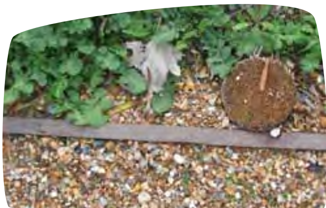
De opsluiting van dit schelpenpad bestaat volledig uit hout. Op de paaltjes is aan de binnenzijde een houten plank bevestigd. Voor deze constructie werd enkel rondom de palen een fundering voorzien.
