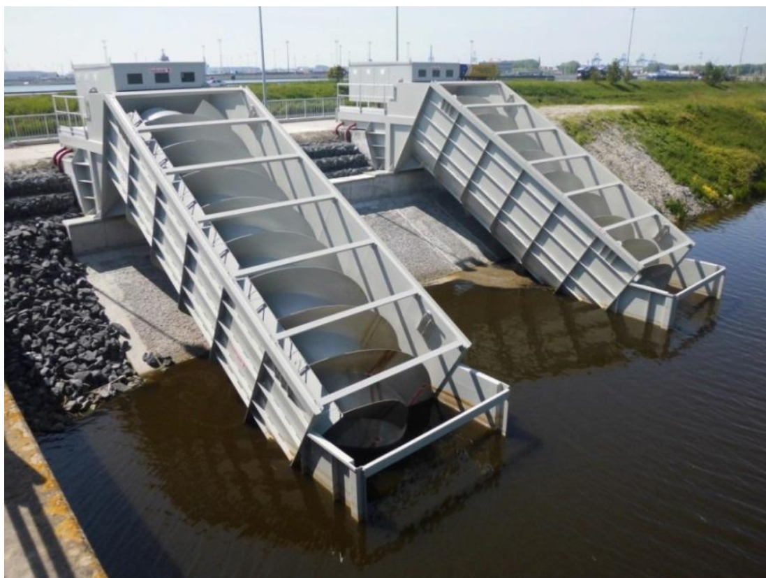
Figuur 3: Vijzelpompen in het Leopoldkanaal die bij hoge piekdebieten het overtollige water kunnen verpompen naar het Afleidingskanaal van de Leie.
