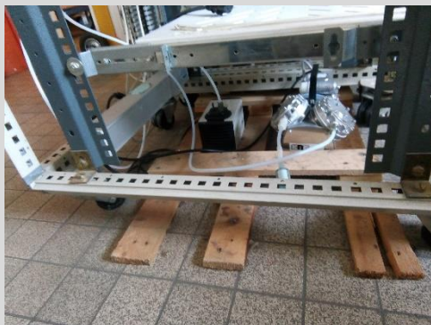
Hout van palletten om pompjes vast te zetten
