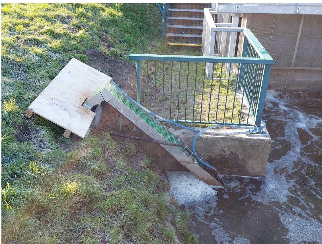
Figuur 25 De experimentele palinggoot die stroomafwaarts van het pompstation in Woumen werd geplaatst.
