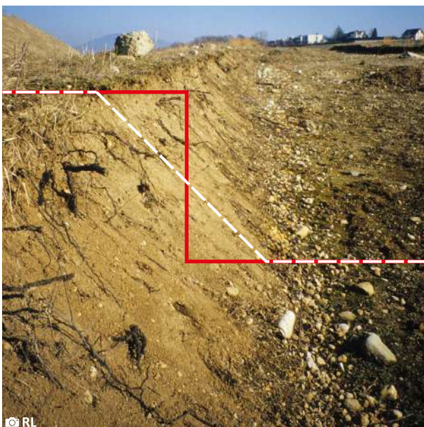
Fig. E96: De wand van een sleuf was oorspronkelijk verticaal (rood). Door droog/vochtig en vries/dooi cycli is de bovenste helft naar beneden geschoven (wit). Dit is te zien aan de wortels die uitsteken en de aarde die de onderste helft van de originele wand bedekt. De hellingsgraad is nu 45°, wat nog te steil is voor het vestigen van vegetatie. De stenen aanwezig in de geërodeerde aarde zijn naar beneden gerold. Boudry, kanton Neuchâtel, Zwitserland.
