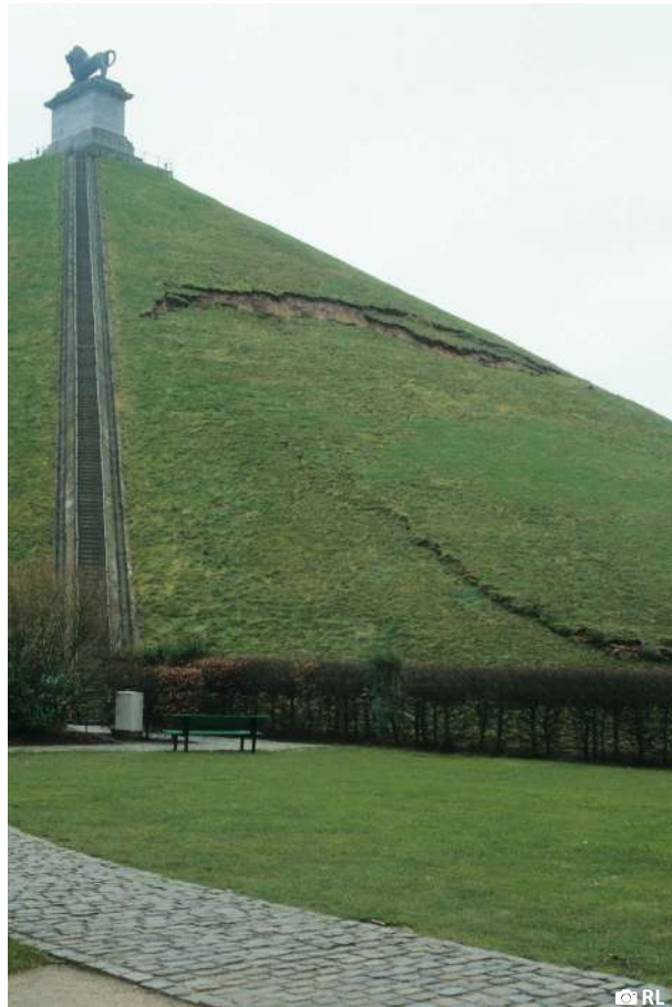
Fig. E110: De 'Leeuw van Waterloo'. Blijkbaar heeft men tijdens de constructie van het monument, lagen aarde gestort die evenwijdig liggen aan de helling van 25°. Hierdoor kan in een periode van hevige neerslag een glijvlak ontstaan wat de kans op grondverschuivingen vergroot. Braine-l'Alleud, provincie Waals-Brabant, België.
