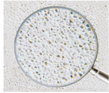
Figuur 72: Poreus oppervlak cellenbeton
