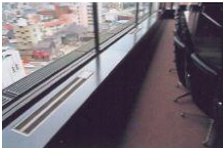
Figuur 205: Ventilconvector ingewerkt onder de ramen
