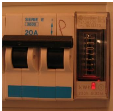
Figuur 143: Extra elektriciteitsteller
