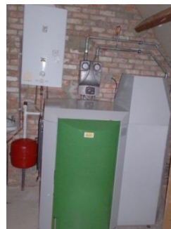
Pelletketel met zuigsysteem en opslag
