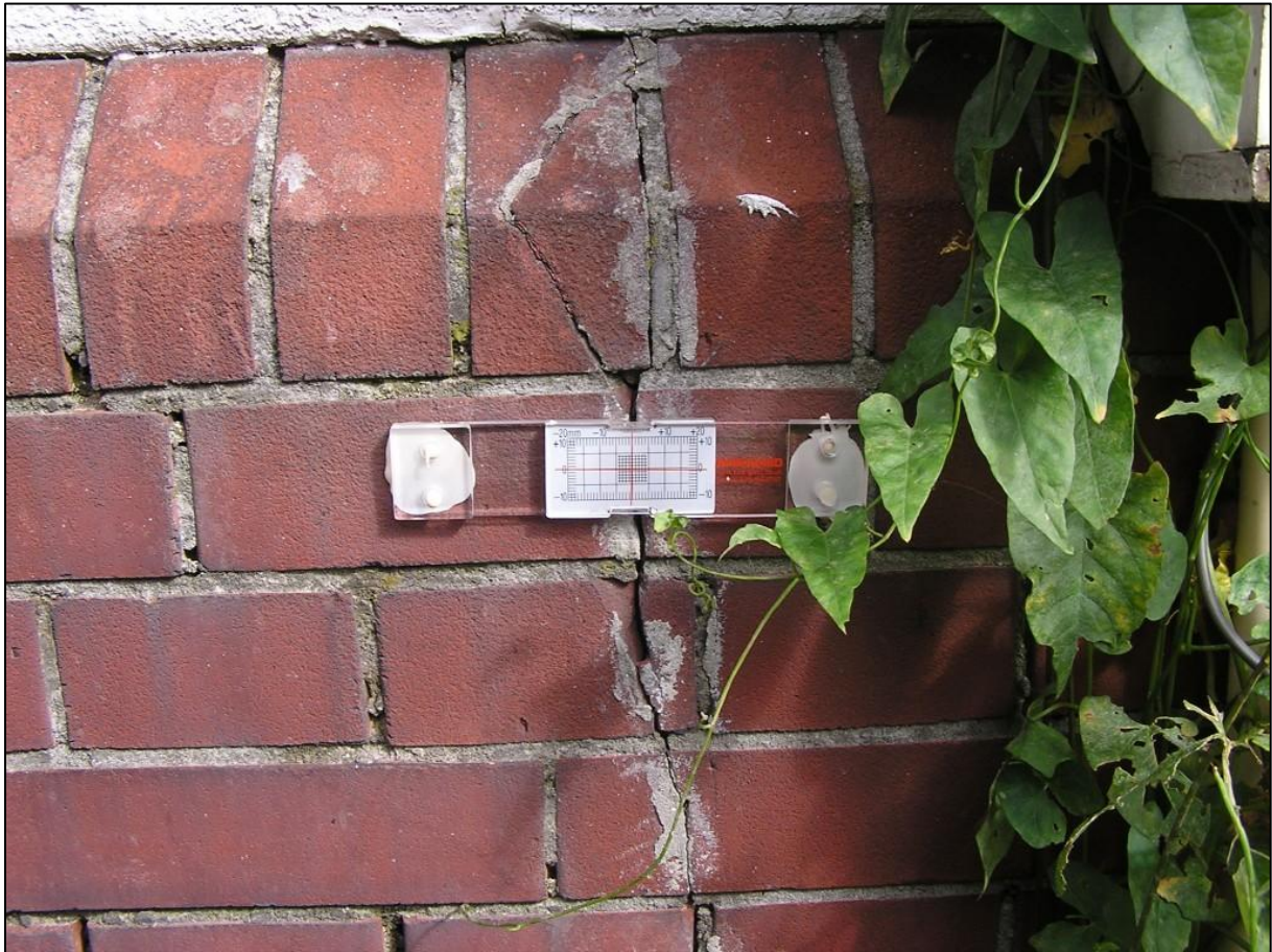
Figuur 6: Voorbeeld van een scheurmeting door middel van een ' Tell-tale '.
