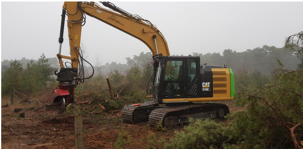
Figuur 15: Eén machine zoals deze kraan met stronkenfrees kan verschillende risico's herbergen; in dit geval een verbrandingsmotor, elektronica, hydraulische leidingen en een snel draaiend aangedreven werktuig (foto: Tom Heylen)
