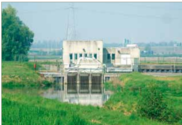
figuur 94: Het pompemaal Keetberg
