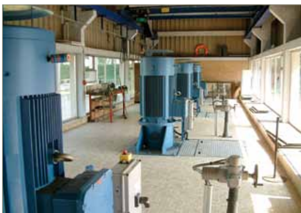
figuur 96: De nieuwe pompen in het pompemaal Stenen Goot
