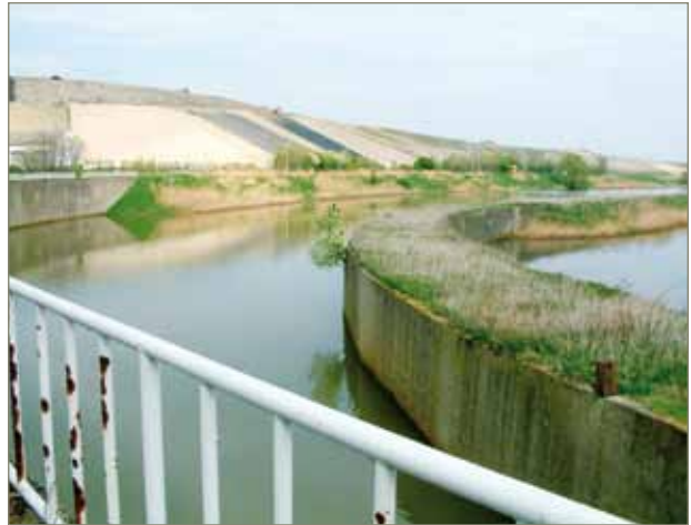
figuur 39: Pompgemaal Verlegde Schijns, Voorgracht (L) Hoofdgracht (R)
