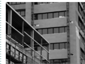
Het Vlaams Administratief Centrum van Leuven is volop in aanbouw. De oplevering is voorzien in november 2010.
